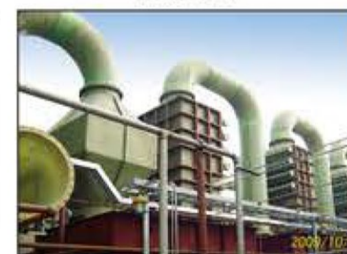
水处理设备 Water treatment device
