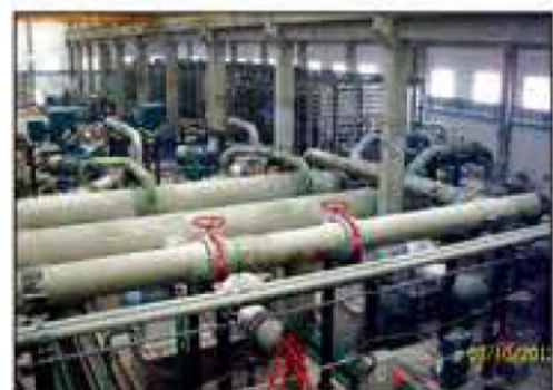
海水淡化管道 Seawater desalination pipe
