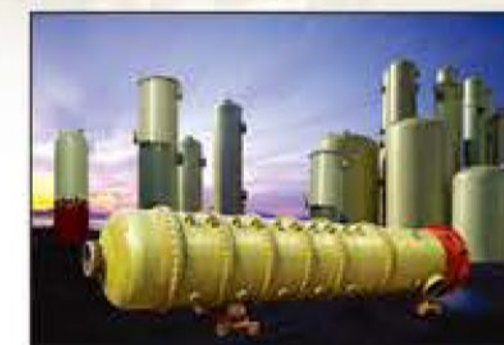
玻璃钢塔器群 FRP towers
