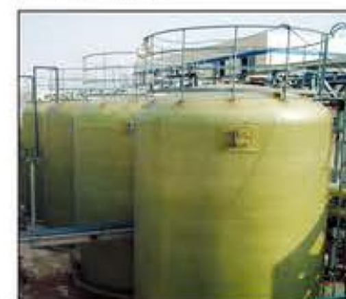
玻璃钢容器群 FRP vessels
